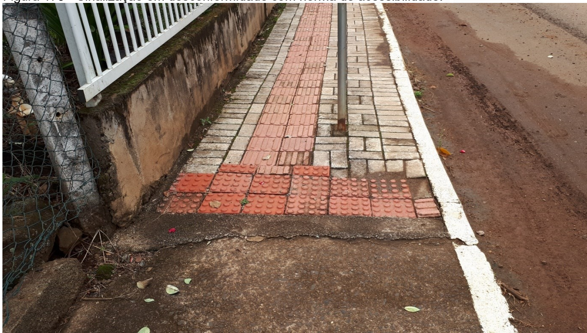
Figura 179 - Sinalização em desconformidade com norma de acessibilidade.
