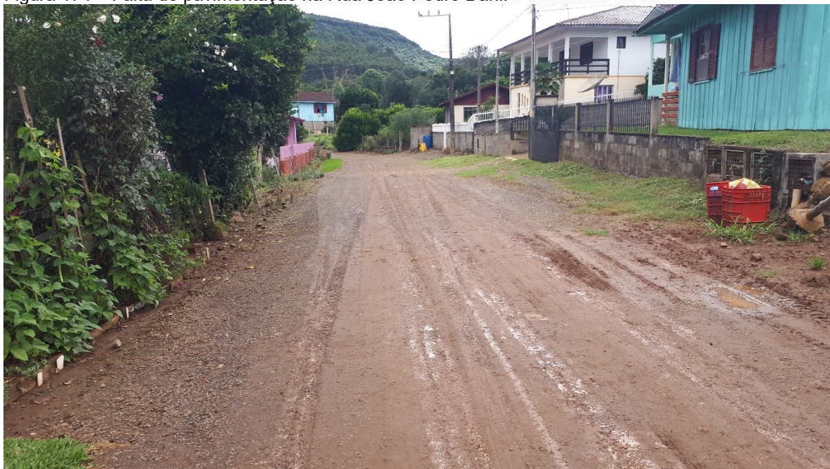
Figura 174 – Falta de pavimentação na Rua João Pedro Dani.
