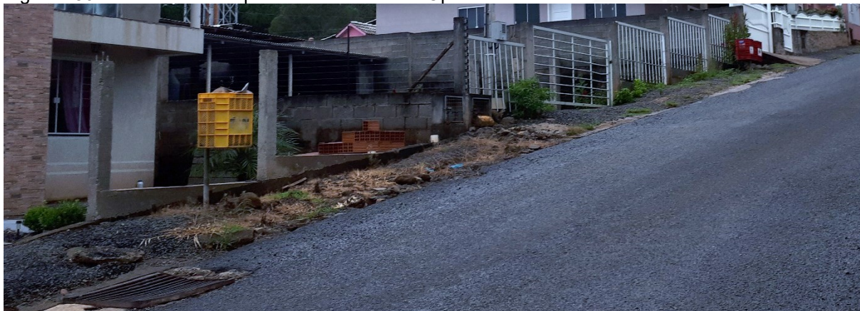
Figura 180 - Inexistência de passeios na Rua dos Operários.
